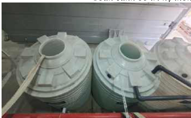
Bể gom nước thải
