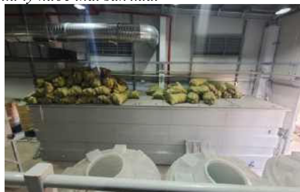
Cụm bể xử lý sinh hóa
