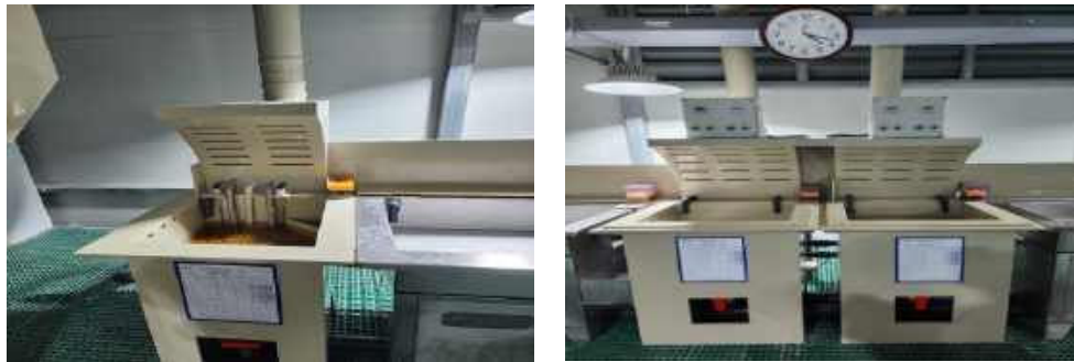
Hình 1. 13. Bể tẩy dầu mỡ trong xưởng mạ điện
