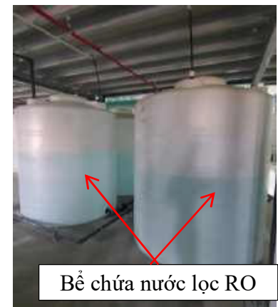
Bể chứa nước RO
