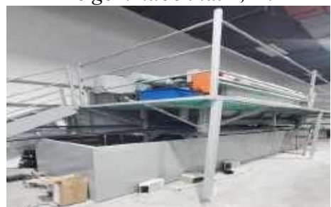
Máy ép bùn + bể chứa nước sạch
