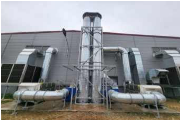
Hệ thống xử lý khí thải của nhà máy
