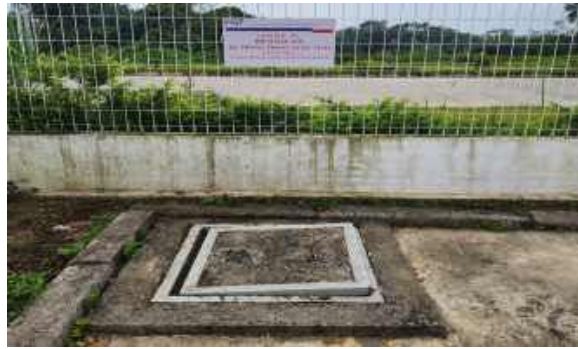
Hình 3. 8. Điểm đầu nổi nước thải của Cơ sở 1 vào hệ thống thu gom, xử lý nước thải tập trung của KCN Cẩm Khê
