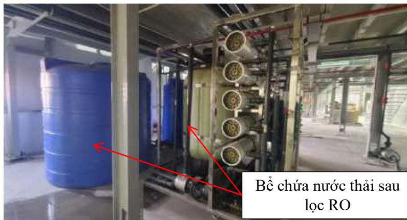
Hệ thống lọc RO
