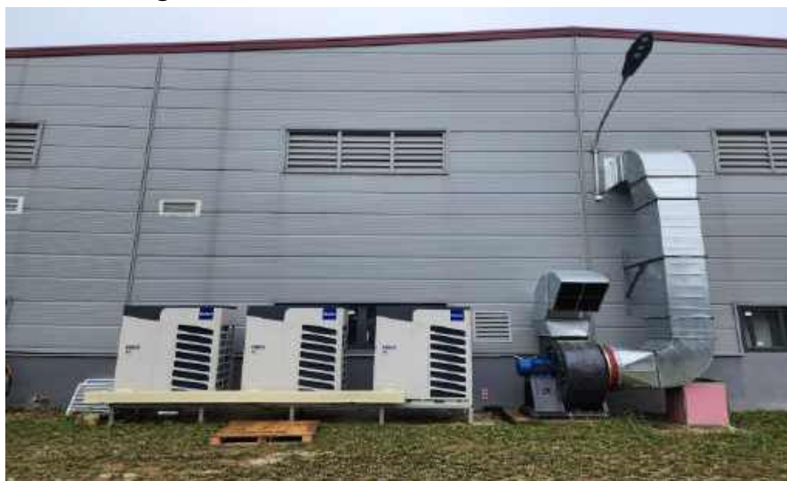
Hình 3. 37. Hệ thống điều hòa không khí của nhà máy
