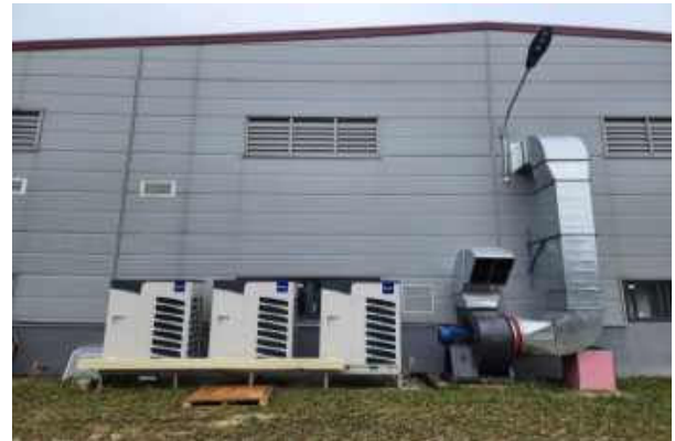
Hệ thống điều hòa Chiller
