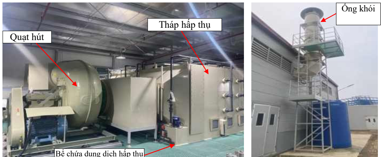
Hình 3. 27. Hệ thống xử lý bụi, khí thải tại dây chuyền mạ điện
